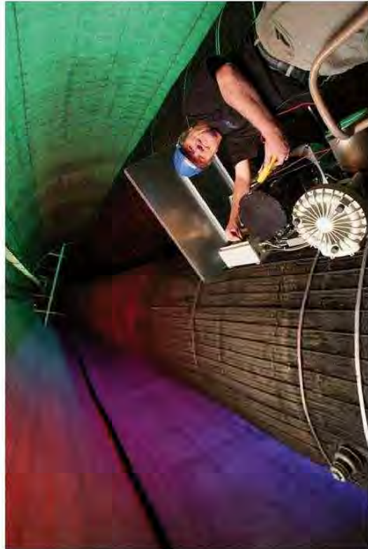
Im Heizkraftwerk der Erlanger Stadtwärke
