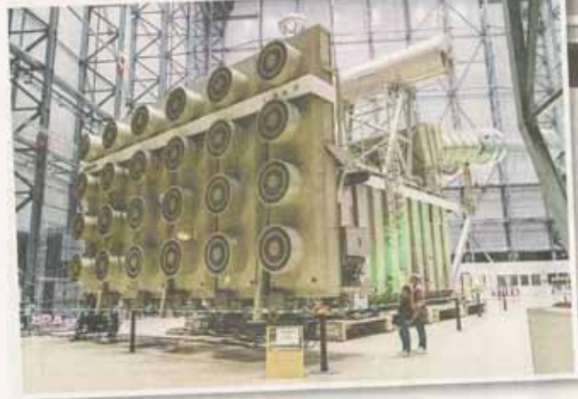
Modernste Technik – wie hier im Siemens Trafowerk – begeistert die Besucher.
